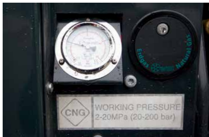
Каждый элемент газовой системы снабжен поясняющей табличкой.
